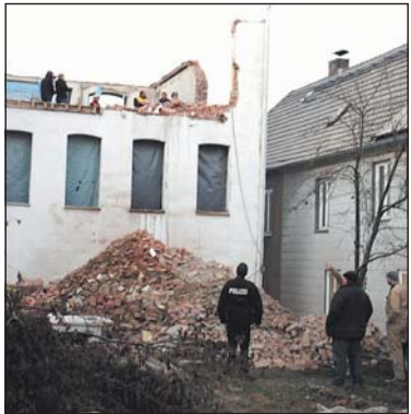
Eine Giebelwand war plötzlich eingestürzt.
